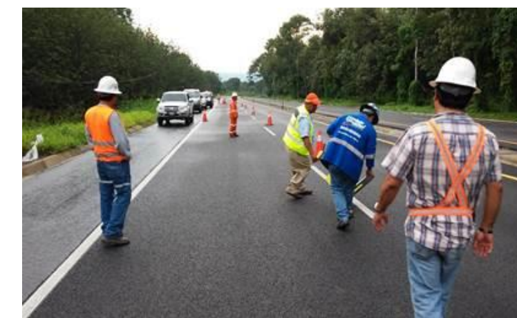
Proyecto: CA-2 Occidente Subtramo III: Puente Carmen de Mirón – Puesto de Aduana Tecún Umán
