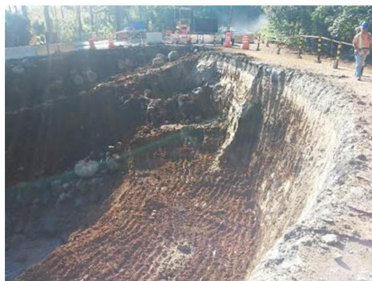
Proyecto: CA-2 Occidente Subtramo III: Puente Carmen de Mirón – Puesto de Aduana Tecún Umán
